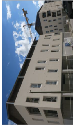
Les nouveaux logements en cours de construction au quartier de la Fiature ou encore au Crêdo ne comptent pas dans les objectifs présentés. Tout simplement parce que ces logements sont déjà construits. Et que là, on parle de perspective à dix ans. Photo: La D.A.S.
