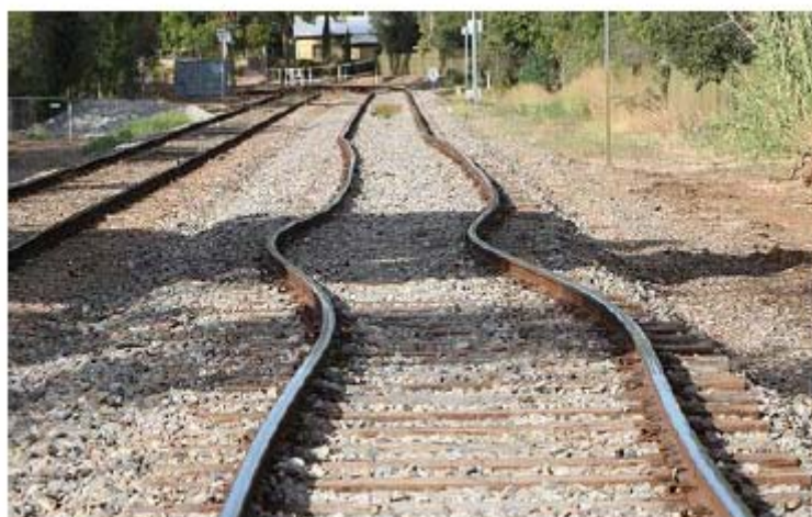
Déformation de rails lors de la canicule de 2003 sur la ligne de RER D
