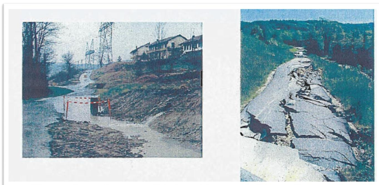
Figure 168: Photos du glissement de la cité de la Bornière (mars et mai 2021) Source : rapport de présentation du PPRN (photos services techniques de la commune d'Injoux-Génissiat)
