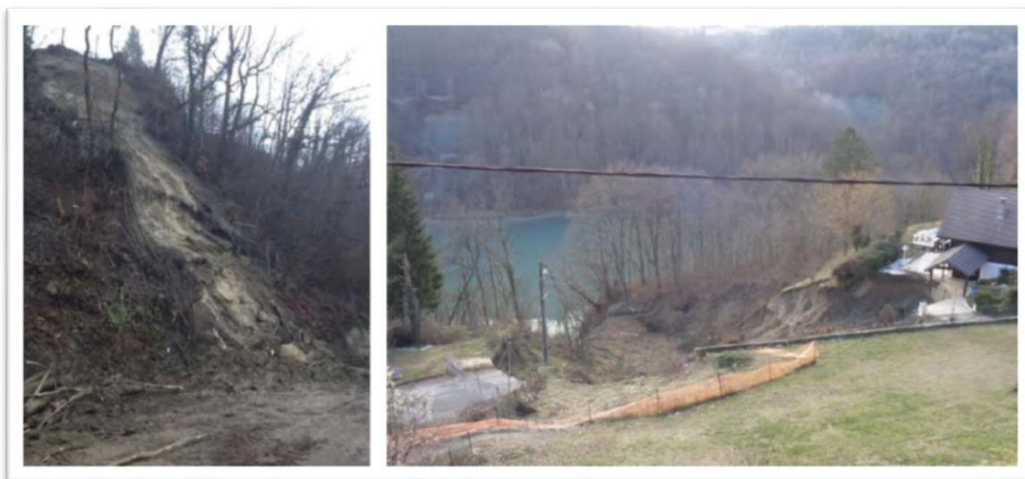
Figure 167: Photos de glissements de terrain à Valserhône (Bellegarde) en 2018 Source : rapport de présentation du PPRN de Valserhône
